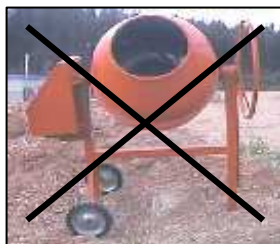
Fig. 1 – Hormigonera desnivelada y sin estabilidad
